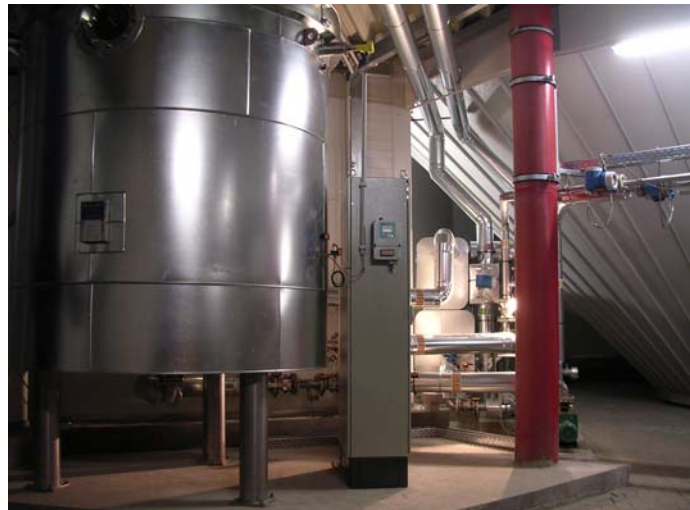
Anlage zur thermisch-chemischen Desintegration auf der Kläranlage Gifhorn
