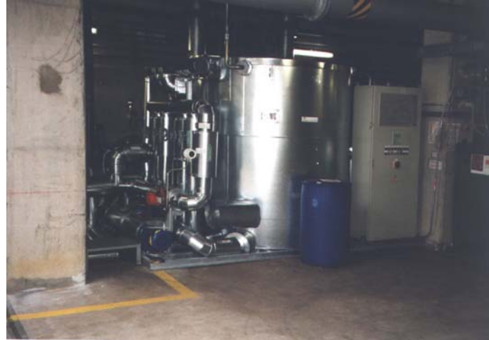
Thermisch-chemische Desintegration auf der Kläranlage Waßmannsdorf
